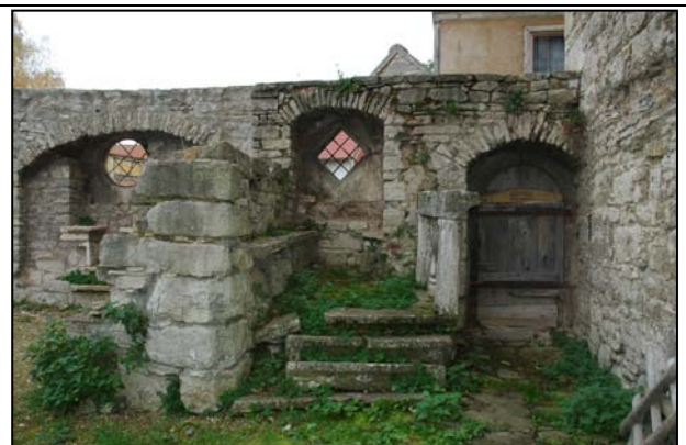
Ostseite der Barbakane (Innenseite) mit großen Fehlstellen im Mauerwerk
