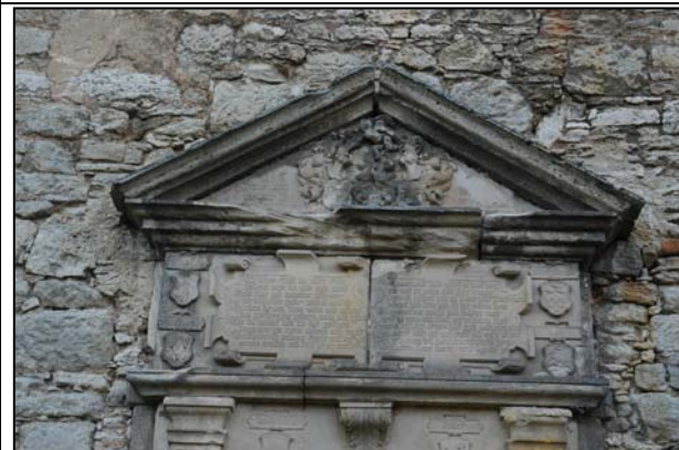
Giebfeld des Hauptportals vor der Sanierung mit zahlreichen Ausbrüchen
