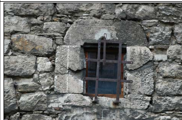
Fenster der Südfassade vor der Restaurierung mit Abschalungen infolge Brandeinwirkung
