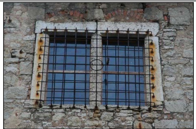
Rostverfärbungen und -sprengungen an den Fenstergewänden
