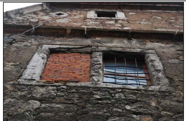
Zustand des Ostgiebels vor der Sanierung mit starken Schäden in der Verfugung
