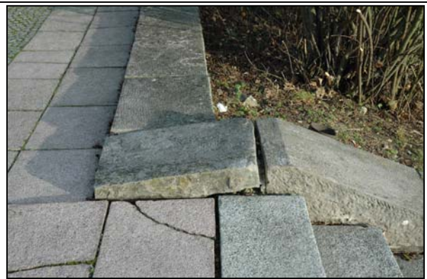
Verwerfung der Treppenanlagen
