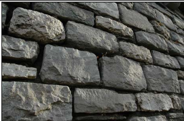
Offene Fugen im Bruchsteinmauerwerk
