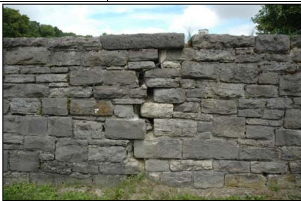
Riss in einer Stützmauer
