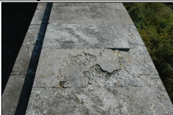
Abschalungen, Ausbrüche an Abdeckungen
