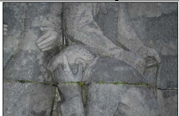
Offene Fugen mit Moosbefall an den Stelen
